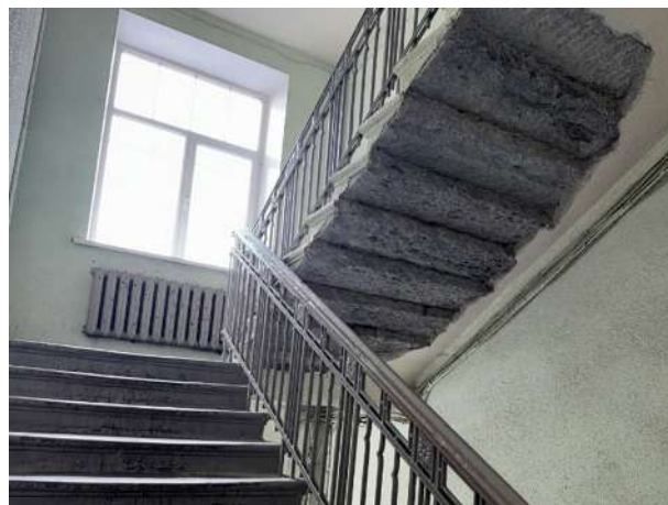
Рис. 8. Лестница в жилом доме 1916 г. постройки, Приморский пр., д. 6. Частичное обрушение штукатурного слоя снизу марша (автор: Ю. Удалов, 2025; фото предоставлено для использования в данной статье)
