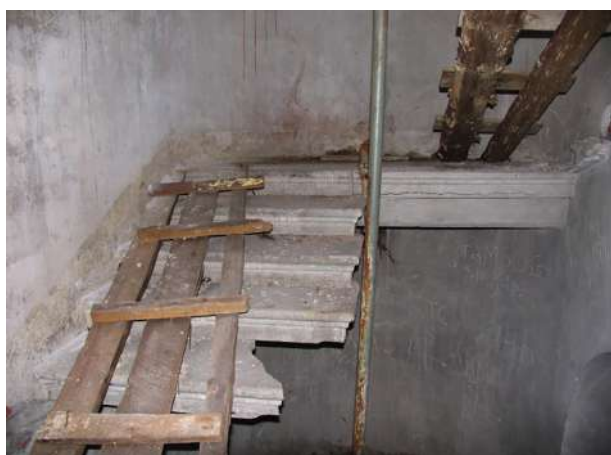
Рис. 15. Лестница в звоннице Морского Никольского собора в Кронштадте до реставрации. Обрушение маршей (фото выполнено авторами, 2009)
