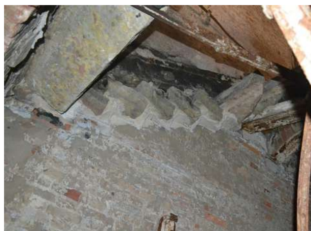
Рис. 16. Обрушение известняковых ступеней при пожаре. Лестница по косоурам постройки 1850-х гг. в Санкт-Петербурге (фото выполнено авторами, 2022)
