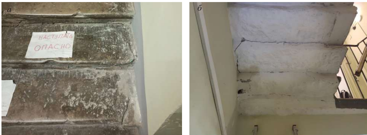
Рис. 14. Излом двух нижних ступеней марша от локальной перегрузки в Здании театрального декорационного зала и экипажного заведения, Б. Подъячская, д. 20: а — трещины в растянутой зоне, истирание и сколы ступеней; б — расстыковка ступеней, ступени плоские, без припазовки (автор: А. Гончаровский, 2021; фото предоставлено для использования в данной статье)
