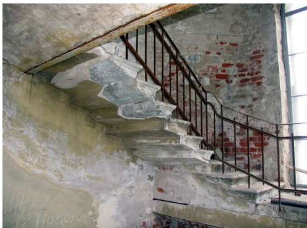
Рис. 7. Черная лестница в звоннице Морского Никольского Собора в Кронштадте. Частичное обрушение штукатурного слоя снизу марша (фото выполнено авторами, 2009)
